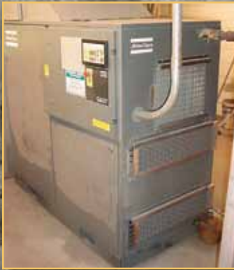
ATLAS COPCO GA37 COMPRESSOR
