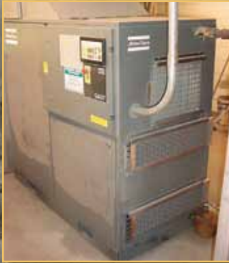
ATLAS COPCO GA37 COMPRESSOR
