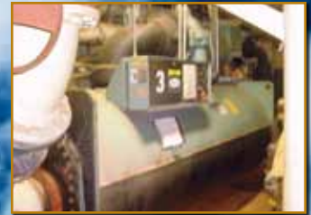
CARRIER 650 TON CHILLER
